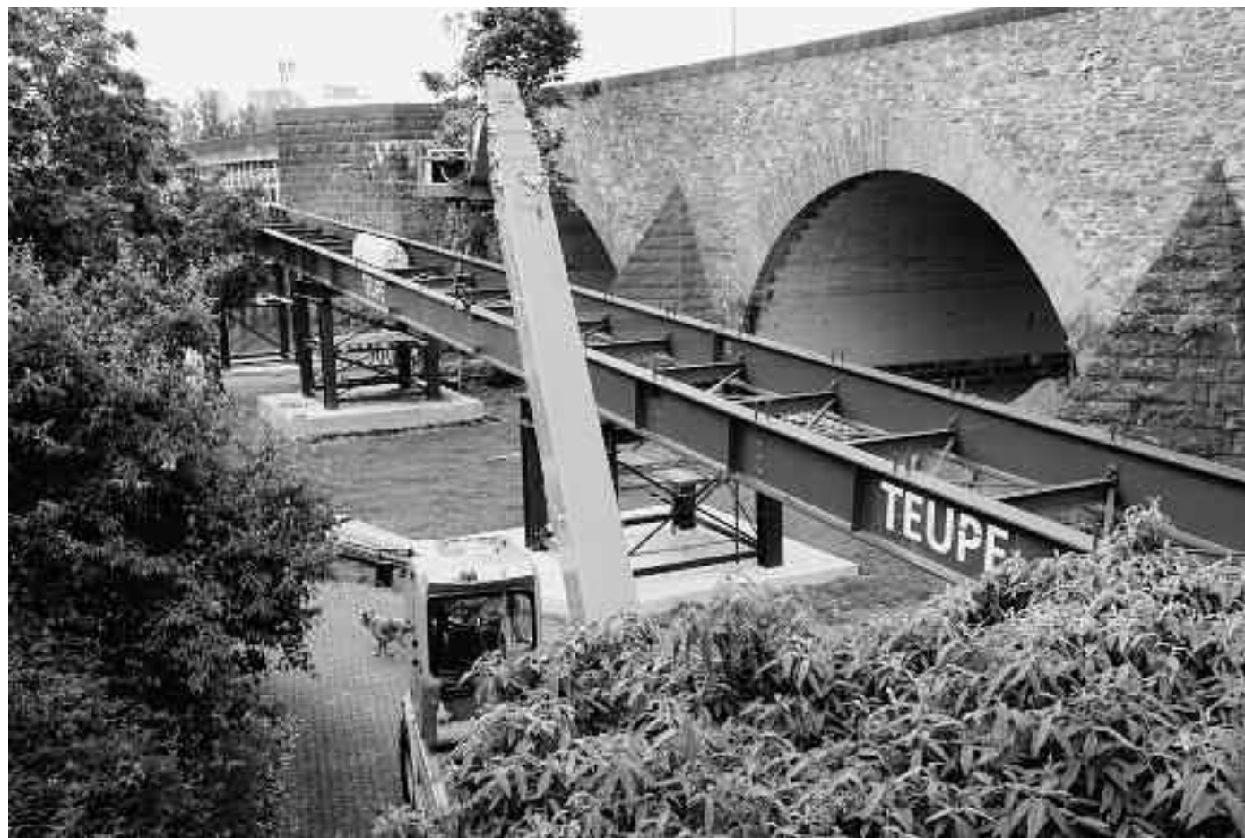
Im Bereich der Lützeler Seite mit einer Länge von 60 m erfolgte die Montage der Brückenelemente auf Betonfundamenten mit Stahlstütztürmen. Hierfür wurde Stahl mit einem Gesamtgewicht von ca. 100 t verbaut. Foto: Teupe & Söhne
