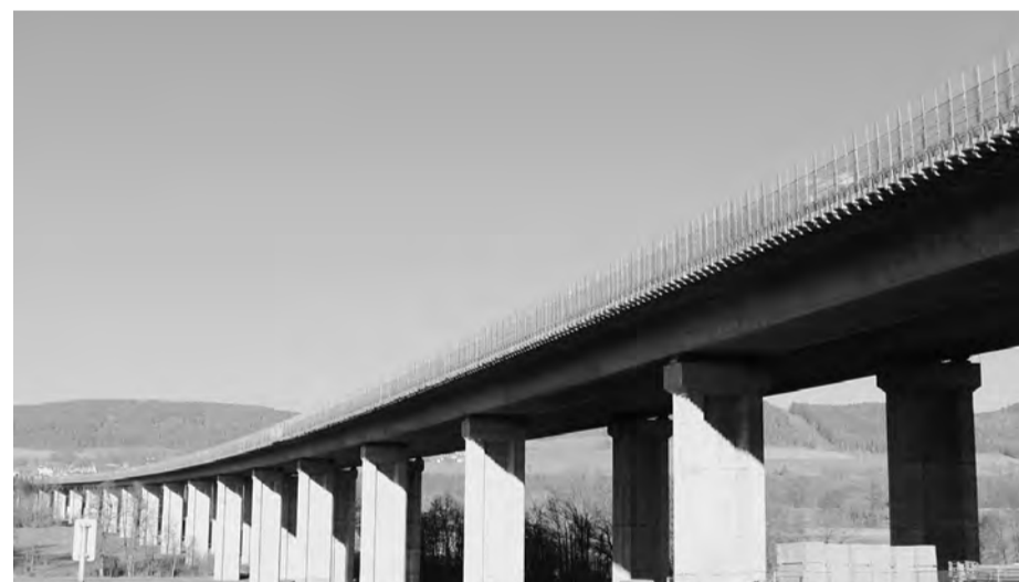
Der Auftrag umfasst die Montage von 2,6 km untergehangenen Trag-, Arbeits- und Schutzgerüsten für den Rückbau beziehungsweise die Neuerstellung der Brückenaußenkappen sowie die Einrüstung der beiden Mittelkappen entlang der Überbaufläche über die gesamte Brückenlänge.
