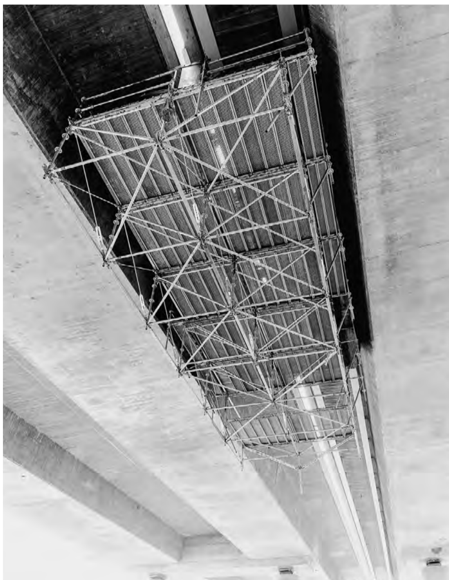
Unterhalb der Überbauten war eine Arbeitsplattform notwendig, um abschnittsweise Stahlträger an der Brückenunterseite montieren zu können – in mehr als 50 m Höhe. FOTO: LAYHER
