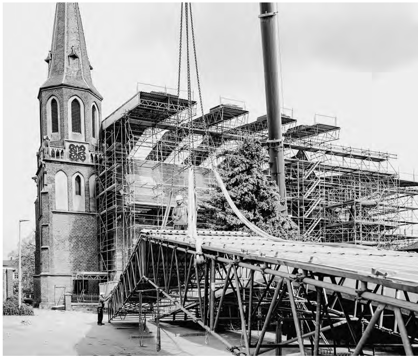
Durch eine statisch ausgefeilte Gerüstkonstruktion aus Super-100 konnte St. Pantaleon Hochneukirch für die Dachstuhlansanierung trotz eingeschränkter Verankerungsmöglichkeiten von Gerüstbau Creutz komplett überdacht werden. FOTO: SCAFORM-RUX
