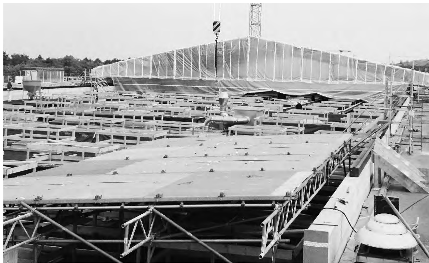
Die Wetterschutzdächer können elektrisch verfahren werden.
