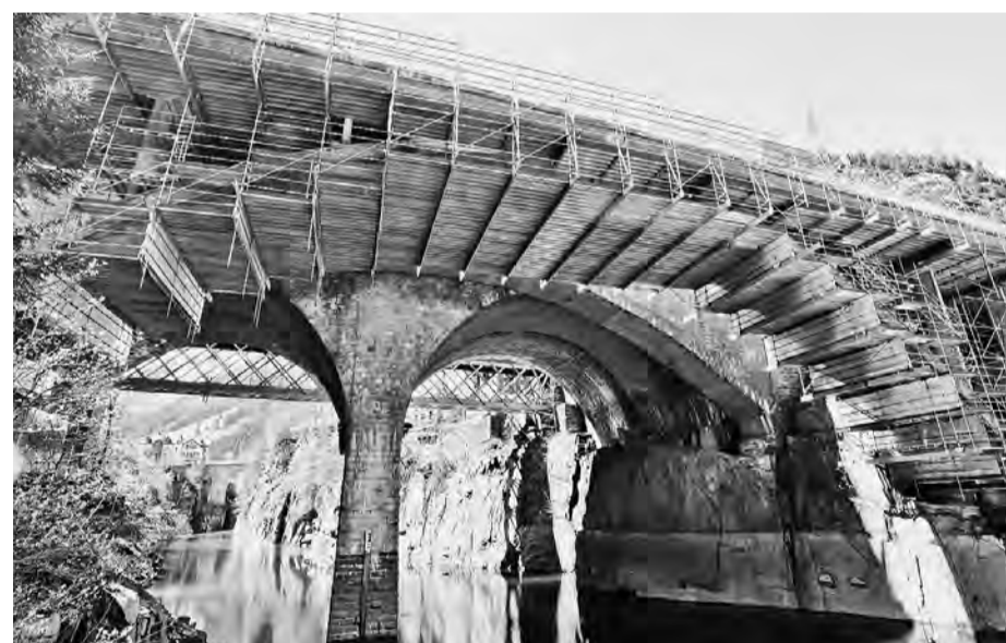
Für eine Brückensanierung konnte mit dem AllroundGerüst in Verbindung mit dem neuen Ergänzungsbauteil FlexBeam eine doppelstöckige Hängegerüsterlösung inklusive Absturz-sicherung für die Arbeiten auf der Brücke sowie Standgerüste im Bereich der Widerlager realisiert werden – aus Serienbauteilen. FOTO: LAYHER
