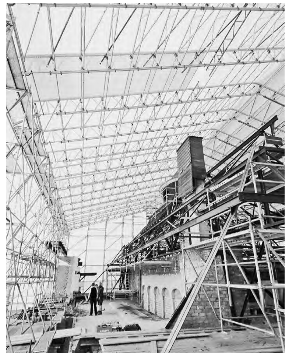
Das Außengerüst diente zum einen als Auflager des Wetterschutzdaches und zum anderen als Fassadengerüst zur Bearbeitung der Fenster und Fassaden.
